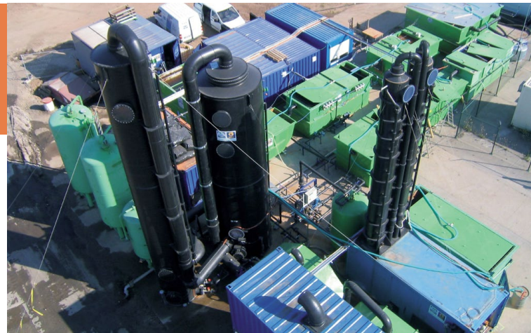
Blick auf die Grundwasserreinigungsanlage beim Projekt Leuna.
