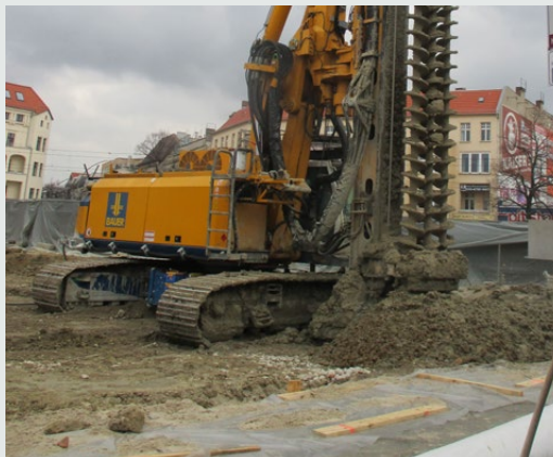
In der Wisbyer Straße in Berlin kam das MIP-Verfahren bereits erfolgreich zum Einsatz.
