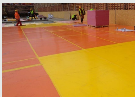
Elastomermatten sollen Erschütterungen durch den Bahnverkehr verhindern.
